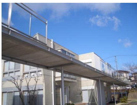
屋外手すりの落下
